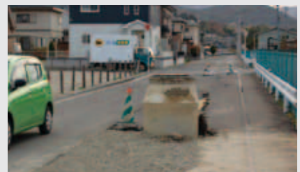
液状化により浮き上がったマンホール
