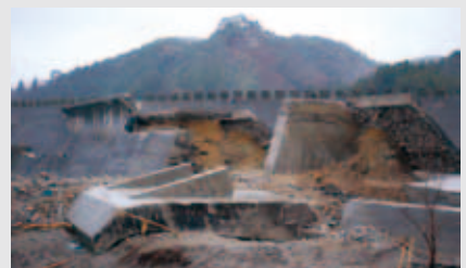
津波で崩壊した防波堤
