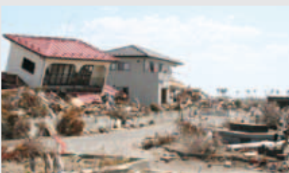
津波被害を受けた住宅①
